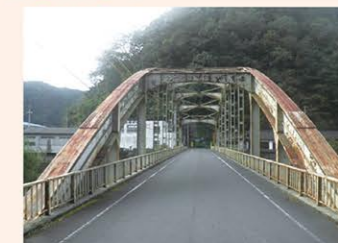
老朽化の進行した橋梁
