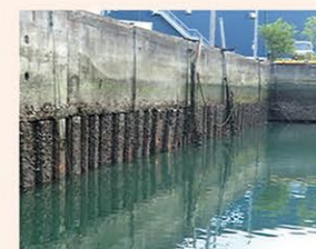
老朽化した港湾施設
