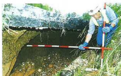
写真②：応急復旧工事前の舗装下の洗掘状況
