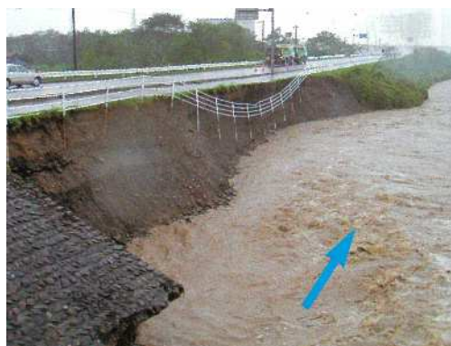
道路兼用護岸の被害状況(西条市)
