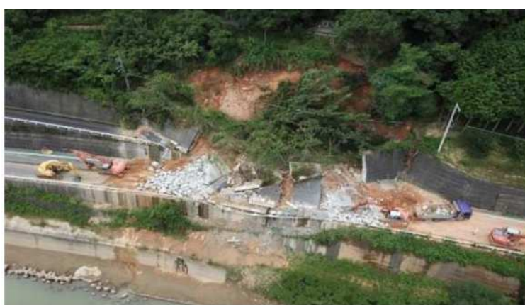
斜面崩壊による被害状況（西予市宇和町）
