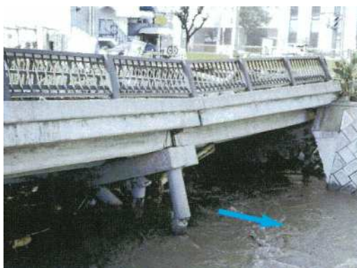
橋梁の被害状況(新居浜市内)
