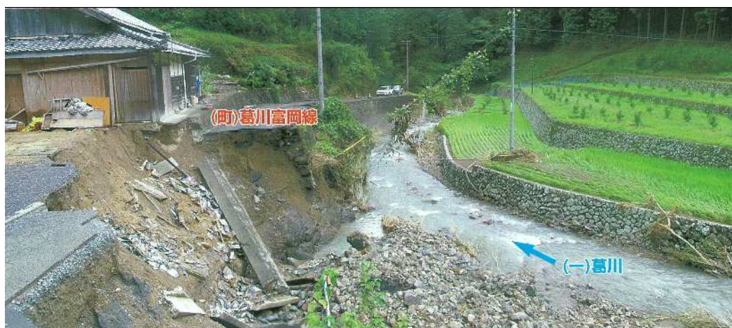
道路兼用護岸の被害状況(松野町)
