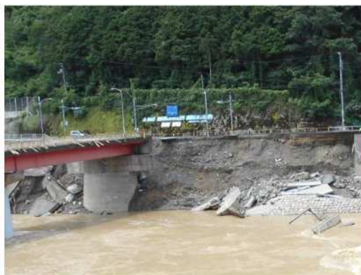
道路兼用護岸の被害状況（大洲市肱川町）
