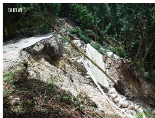
擁壁の被害状況（四国中央市新宮町）
