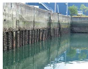
老朽化した港湾施設
