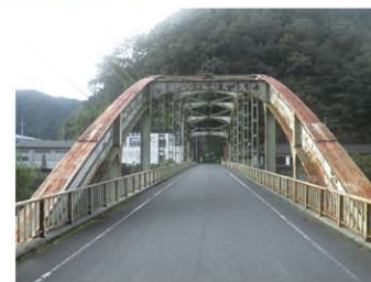
老朽化の進行した橋梁
