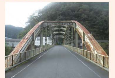
老朽化の進行した橋梁
