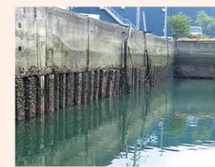
老朽化した港湾施設
