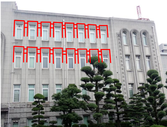
外壁窓周りコーキング(西面)
