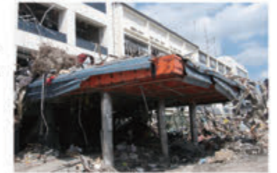
東日本大震災時の陸前高田市役所の玄関。大規模災害時には行政も機能できなくなる。
