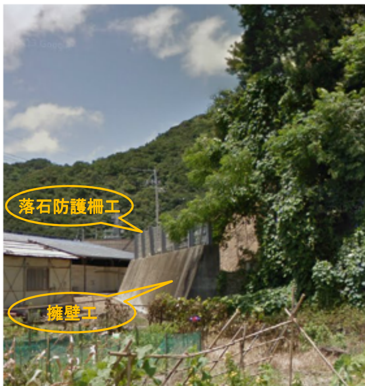
がけ崩れ発生前
