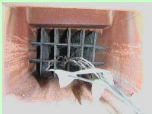
ガス窯煙道への装着時
