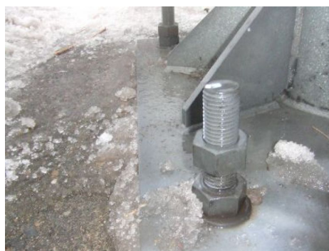
写真 解 3 . 4 設置後 1 年程度の附属物のアンカーボルトのゆるみ
