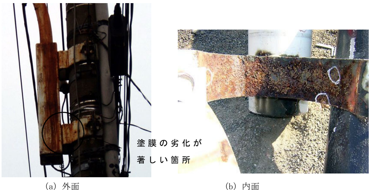
図-5 共架型バンド部における塗膜の劣化例
