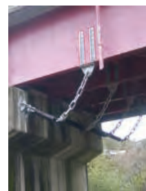
落橋防止装置 (緩衝チェーン)
