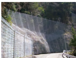
落石防止工 (落石防護網)
