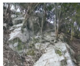
落石防止工 (ワイヤーロープ掛け工)
