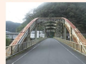
老朽化の進行した橋梁
