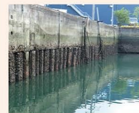
老朽化した港湾施設
