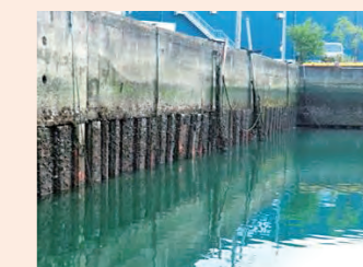
老朽化した港湾施設
