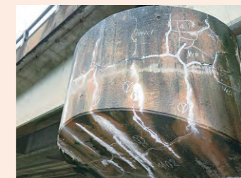
老朽化の進行した橋脚
