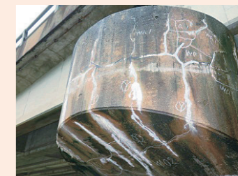
老朽化の進行した橋脚
