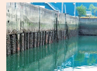
老朽化した港湾施設
