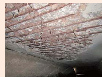
例:老朽化の進行した床板下面
