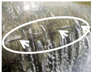
ゴム体の劣化による亀裂
