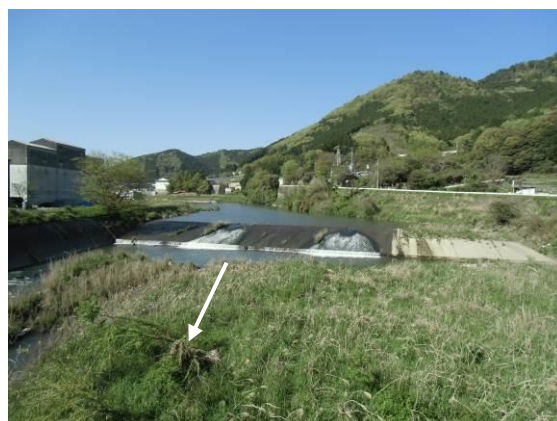
写真4-4 未整備状況 SP 3220 付近下宇和橋上流
