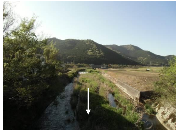
写真4-10 未整備状況 SP1380付近新開橋上流
