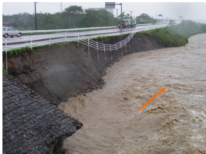
写真 3-7 被災状況写真 (10K300 付近)
