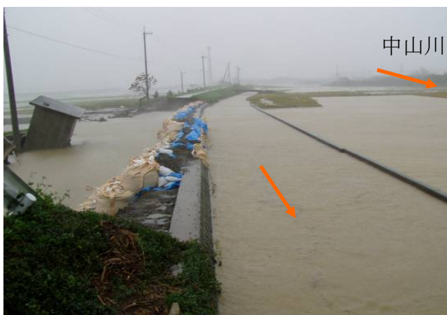
写真 3-8 都谷川破堤状況
