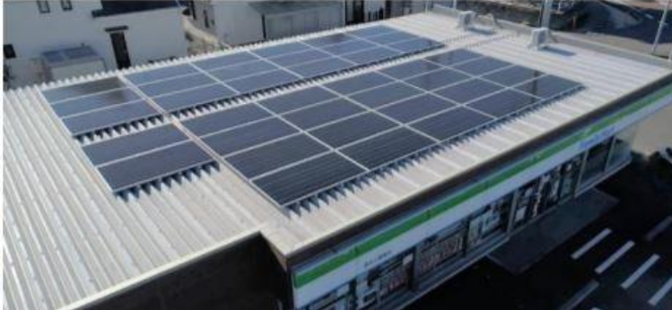
太陽光パネル
