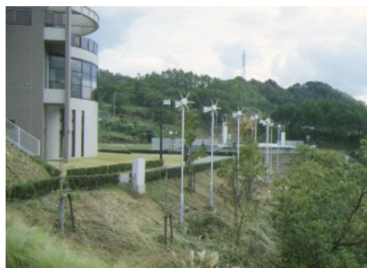
(大洲市: 肱川風の博物館の小型風力発電設備)
