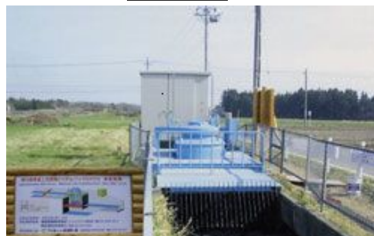
(栃木県那須野ヶ原地区農業用水路小水力発電)
