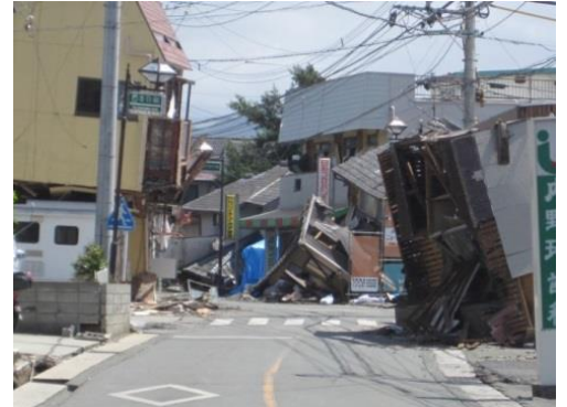
地震で損壊した建物
