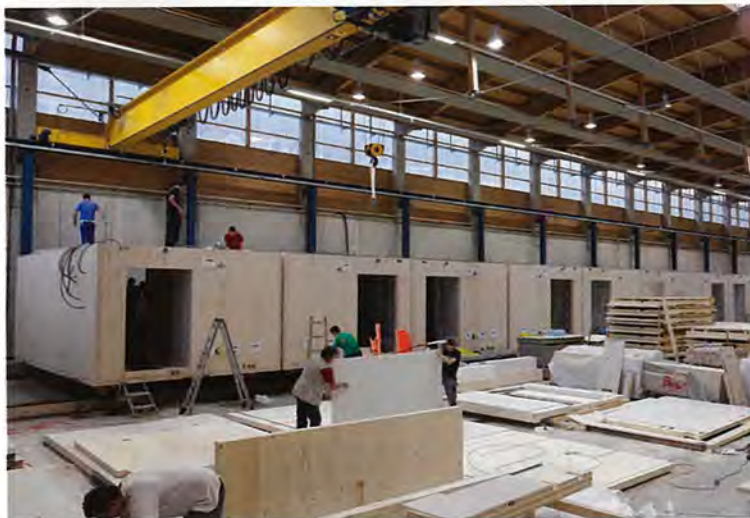
工場でプレファブ化し、配線や内装工事を済ませて現場に搬入
