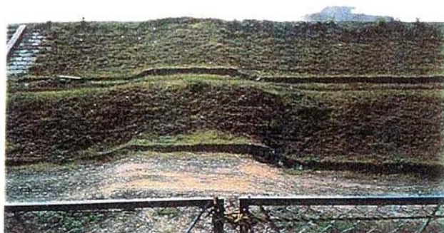
図-参 3.10 天端及び法面の抜け上がりの例
