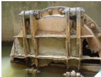
ポンプ設備の逆流防止弁の破損状況
