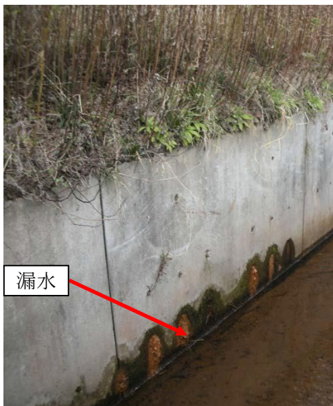
図-参 3.8 堤脚水路からの漏水
