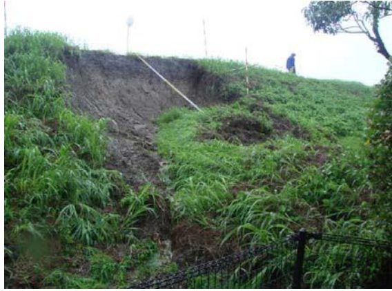
図-参 3.2 出水後の法崩れの状況
