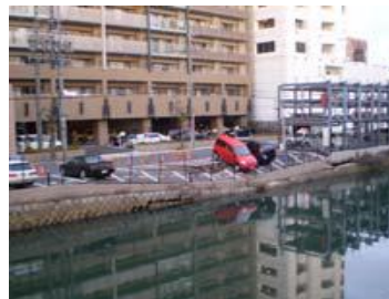
鋼矢板護岸の損壊状況
