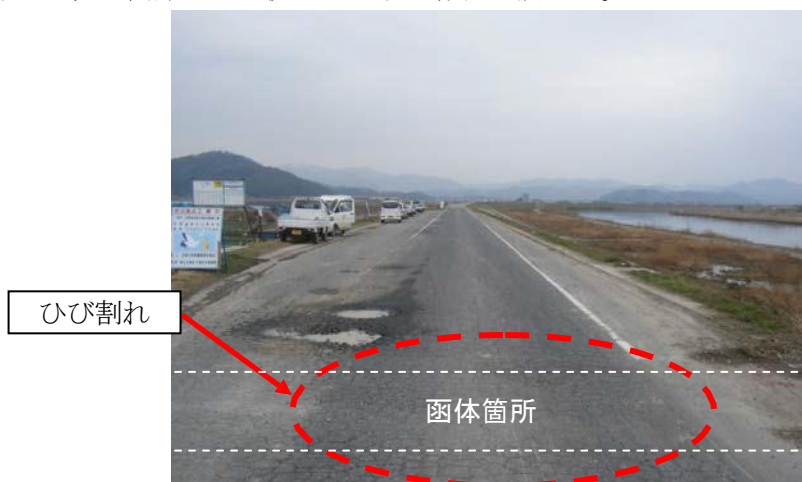
図-参 3.9 天端舗装のひび割れの例
