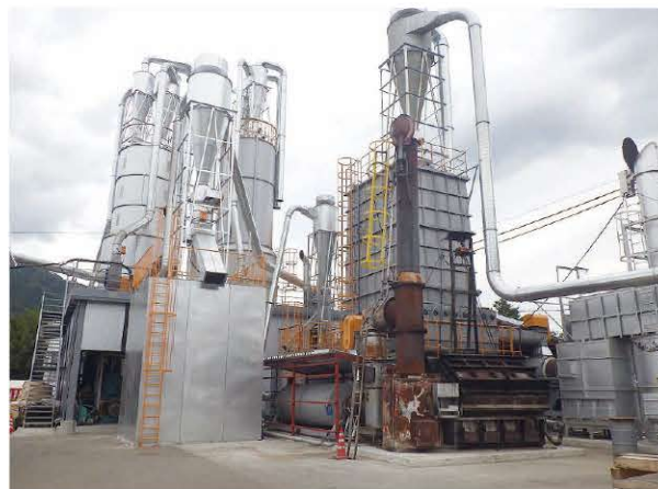
木質バイオマス発電所
