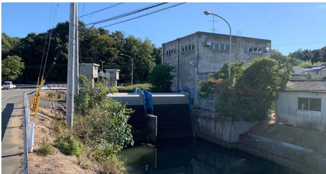
写真 6.1. 老朽化した桜井河口排水ポンプ場
