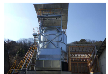
整備した堆肥製造施設
