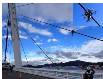
斜張橋ケーブル点検ロボット
