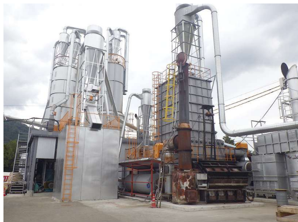
木質バイオマス発電所
