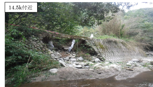
図 石手川 護岸崩壊 (令和5年7月2日 梅雨前線)
