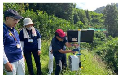
実証ほへの機器設置
