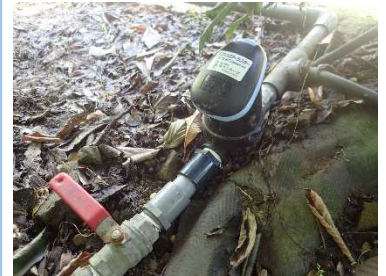
【図7】設置した電磁弁
