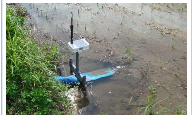
[図9] 自動開閉式給水ゲート
