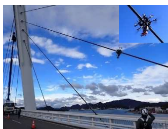
斜張橋ケーブル点検ロボット
