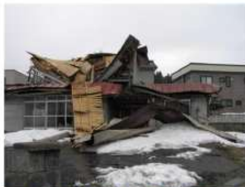
積雪により屋根が落下した空き家
