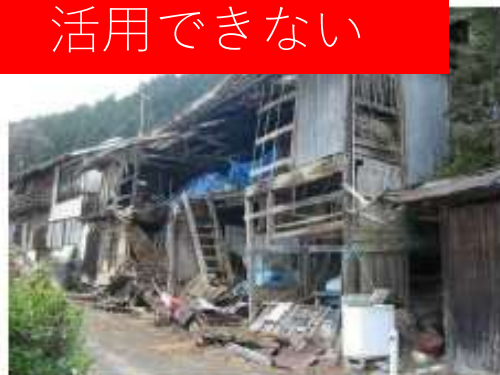
倒壊のおそれのある空き家
