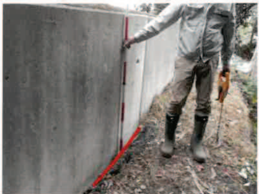
⑥YSP-20+5 付近 擁壁とかご枠の隙間 (かご枠の変形)
