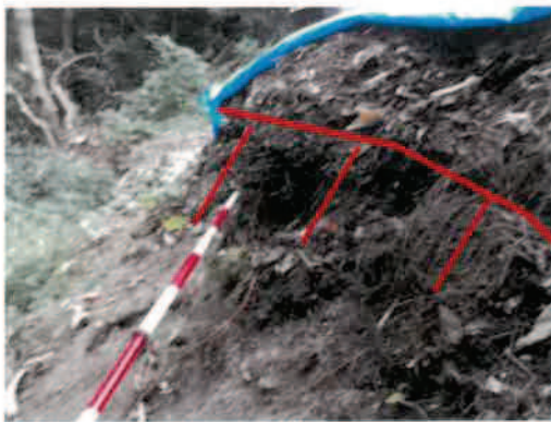
⑨YSP-30 付近斜面 表層崩壊
