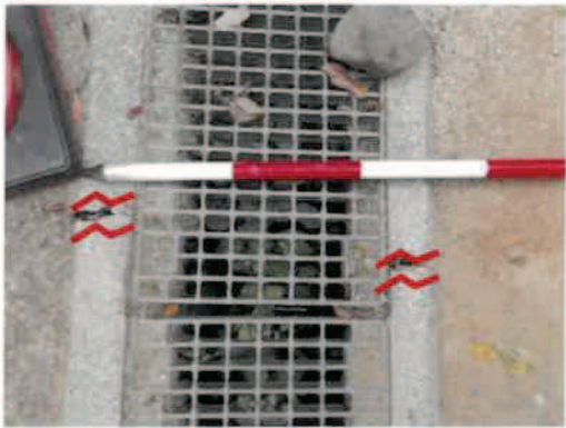
①YSP-0 付近水路に発生したクラック
