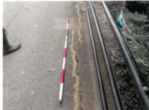
⑭擁壁天端付近にみられる亀裂（沈下+右横ずれ）
