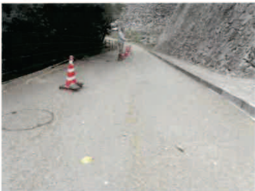
⑬路面の亀裂（YSP30 から YSP20 付近）
