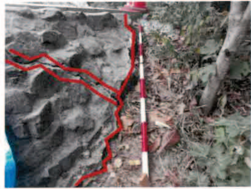
⑩終点側取り付け部（石積）前面地盤の沈下
