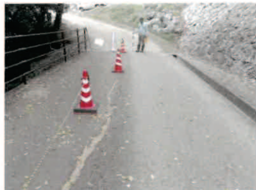
⑯路面の亀裂（YSP10 から YSP0 付近）
