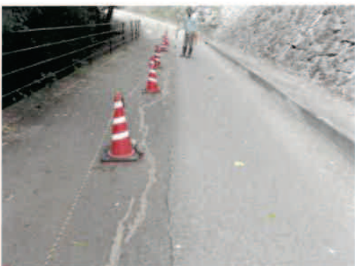
⑮路面の亀裂（YSP20 から YSP10 付近）
