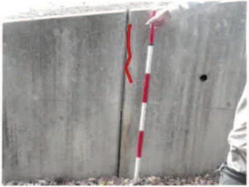
④YSP-10 付近 継ぎ目付近に発生した圧縮亀裂
