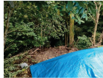
路肩崩壊（A箇所）
