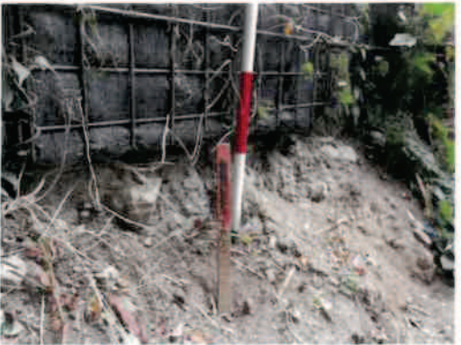
⑧YSP-20+6.2 付近 カゴ枠下部地盤崩壊
