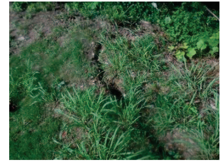
ひび割れ発生（B箇所）
