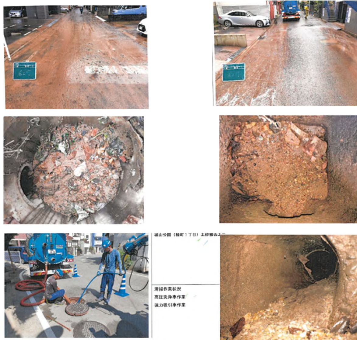
写真3-3 2023年7月1日の冠水被害（上）原因となった排水管・柵の土砂閉塞状況、復旧工事の様子（下）
