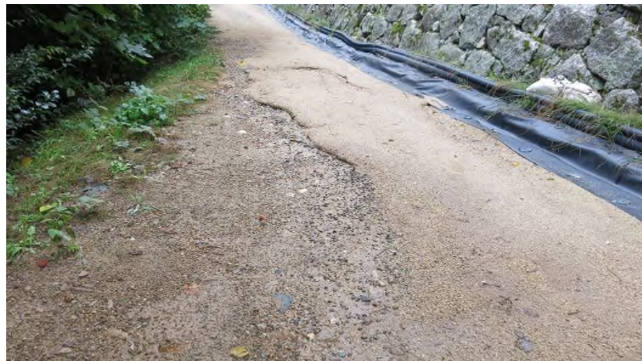
写真② 緊急車両用道路上の流水跡
