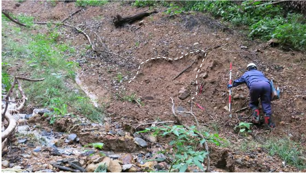
写真⑨ 唯一の変状（洗堀による表層崩壊）
