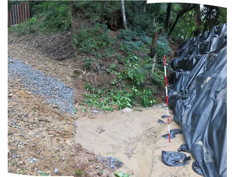
写真⑬ 大型土嚢背面の土砂堆積状況（20 cm程度）
