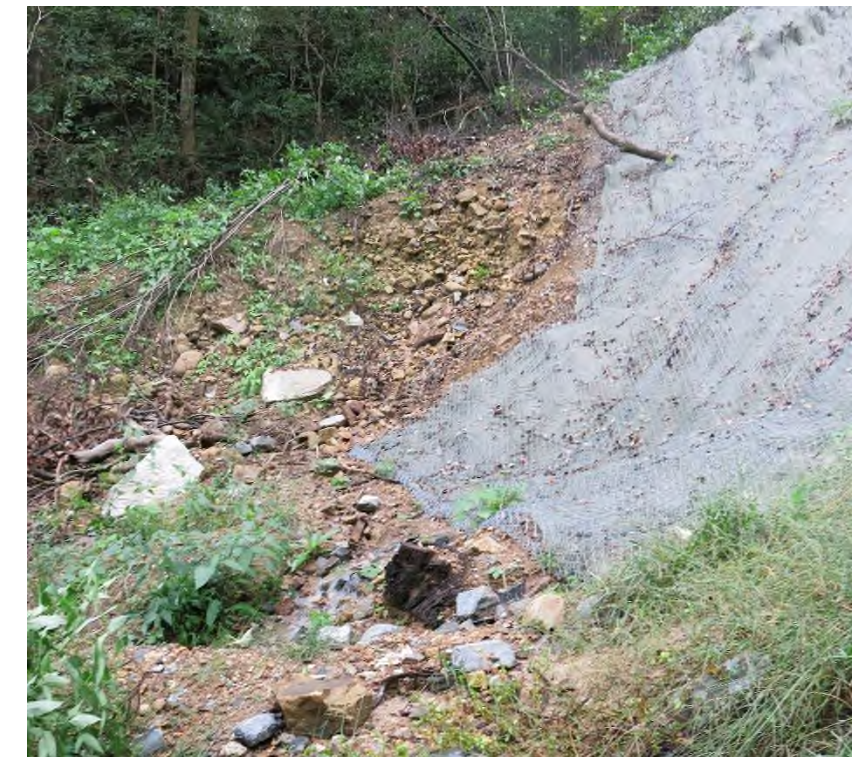
写真⑧ 上流部上部の集水管所状況 （斜面内表流水とB箇所流下域合流部からの湧水）
