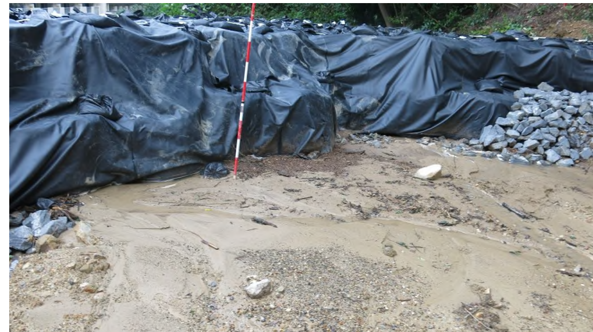
写真⑭ 大型土嚢側部の背面土砂堆積状況（20～40 cm程度） 流出土砂部分に溪流の流水が混ざり泥濁化したもの 溪流からの土砂ではない。
