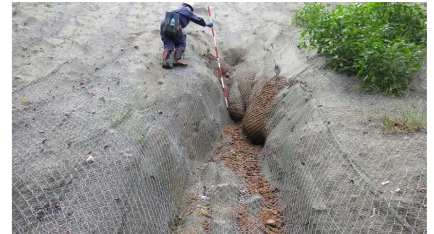
写真⑦ 上流部上部の最上部湧水箇所（しみだし）
