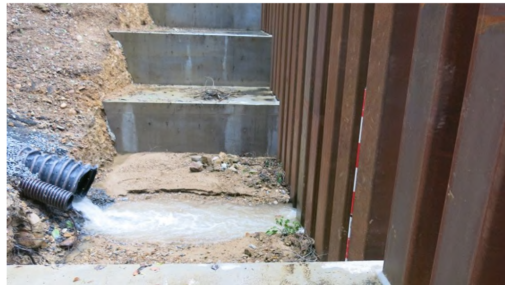
写真⑪ 仮設対策工 VCCO は、14 : 00 で 40 cm の土砂が堆積。 中央部の流水確保作業後 16 : 00（写真）は 20 cm の土砂堆積となっている。
