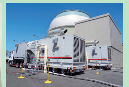
空冷式非常用発電装置
