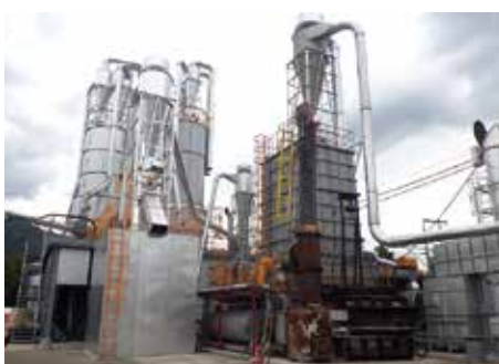
木質バイオマス発電所
