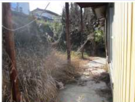
雑草が繁茂した空き家
