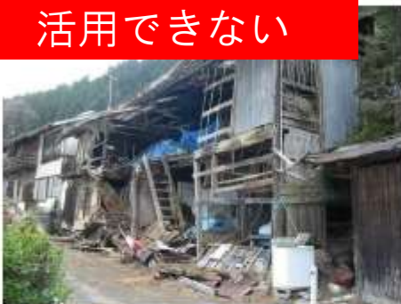
倒壊のおそれのある空き家
