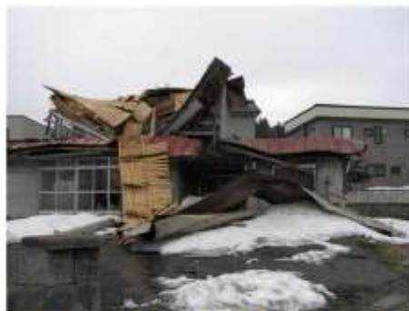
積雪により屋根が落下した空き家
