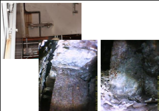
支点上補剛材の状態
