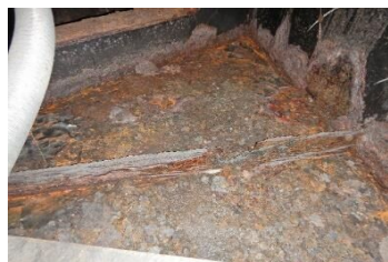
下フランジの状態
