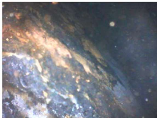
地覆内部で滞水を確認：波板側面腐食状況
