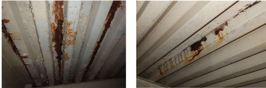
損傷の面積が大の例（拡がりのある発錆箇所が複数ある例）
