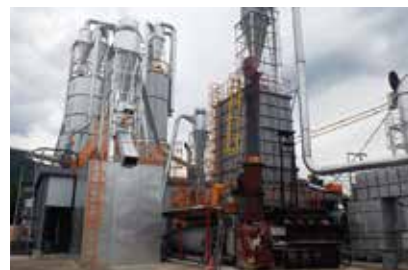
木質バイオマス発電所
