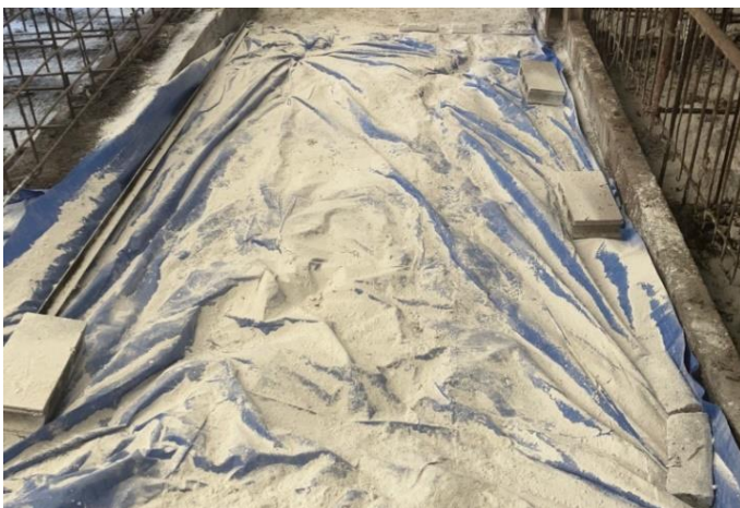
⑤ 汚染物品の封じ込め (11/3 撮影)
