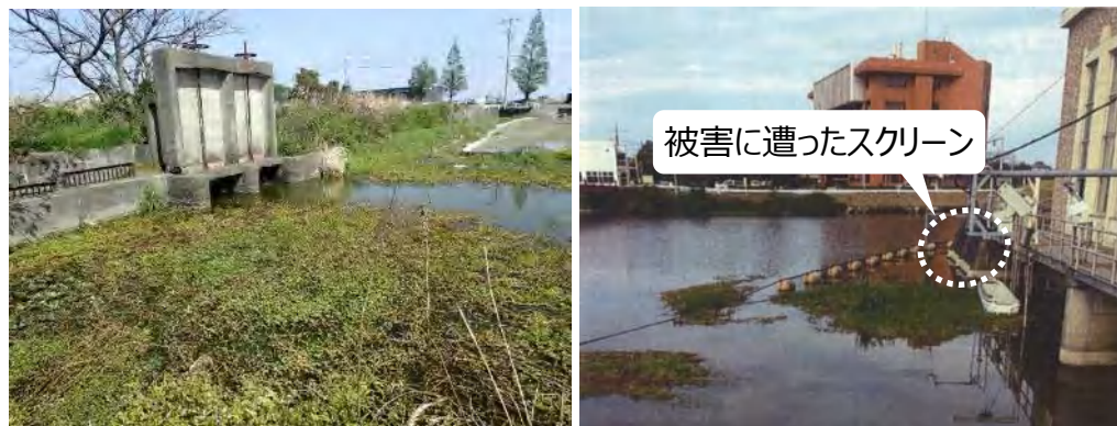
水路を閉塞し、取水・排水の障害となる 排水機場のスクリーン周辺に溜まり目詰まり
