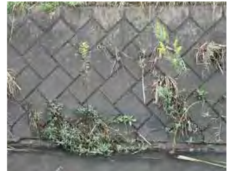
コンクリートブロックの隙間に根を張る株
