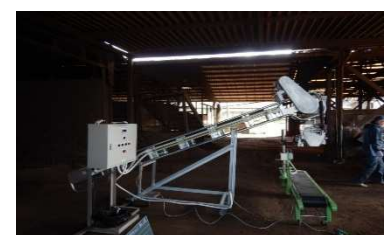
堆肥搬送計量装置の導入
