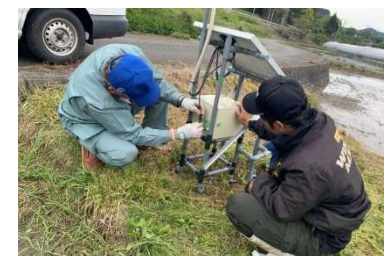
図6 水田用水位センサーの設置
