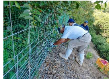
図24 侵入防止柵の補強対策
