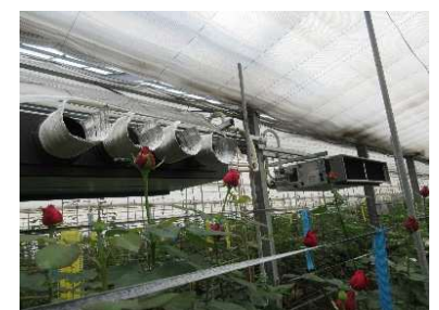
ばらハウスのヒートポンプ
