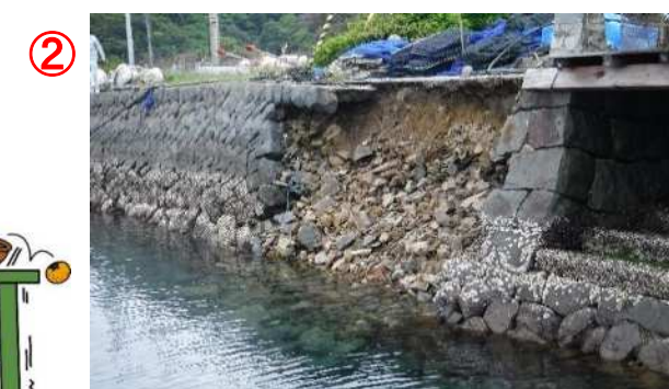
護岸の崩壊(須下漁港:宇和島市)
