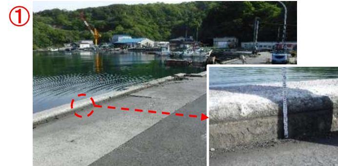
エプロン部の沈下(魚泊漁港:宇和島市)
