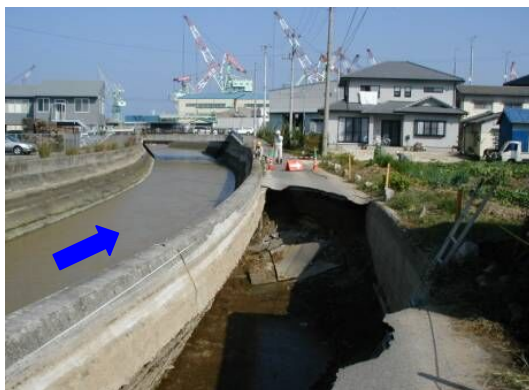
今治市 (二)山之内川 吸出しによる道路陥没
