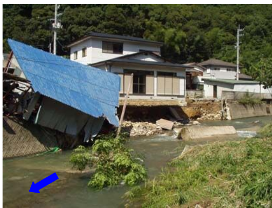
宇和島市 (二)薬師谷川 護岸崩壊
