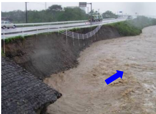
西条市 (二)中山川 護岸崩壊
