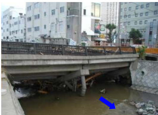
新居浜市 (二)尻無川 橋梁被災
