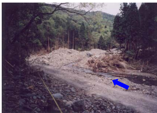
被災状況 護岸が流出し河道が埋塞
