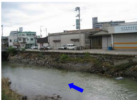
新居浜市 (二)東川 護岸崩壊
