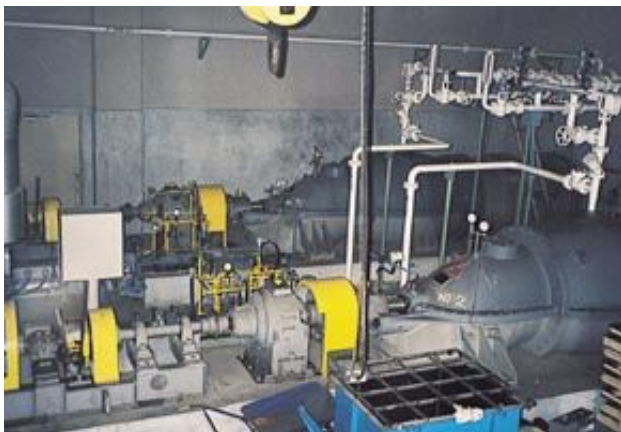
揚水ポンプ 王子川（新居浜市）
