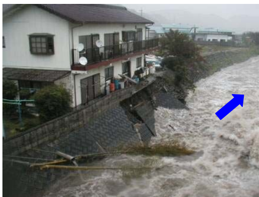
四国中央市 (二)関川 護岸崩壊
