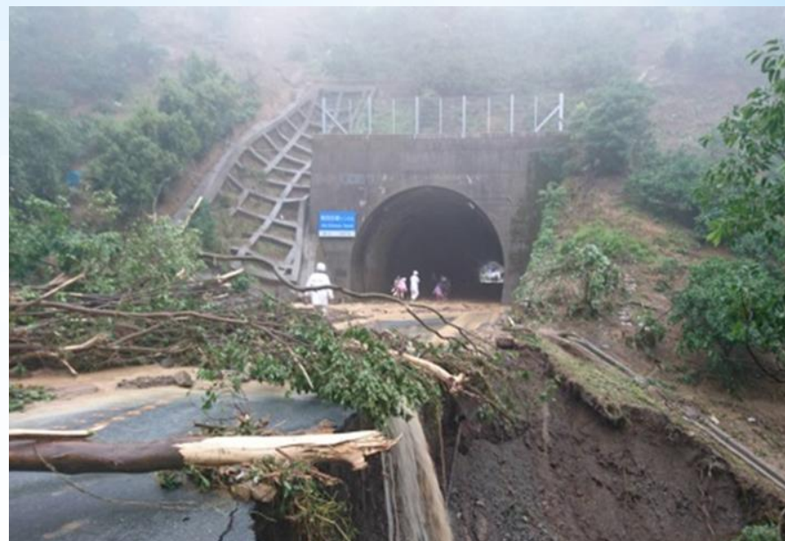
国道56号線(宇和島市吉田町白浦)の道路損壊
