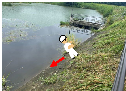
(ため池堤体の急傾斜)
